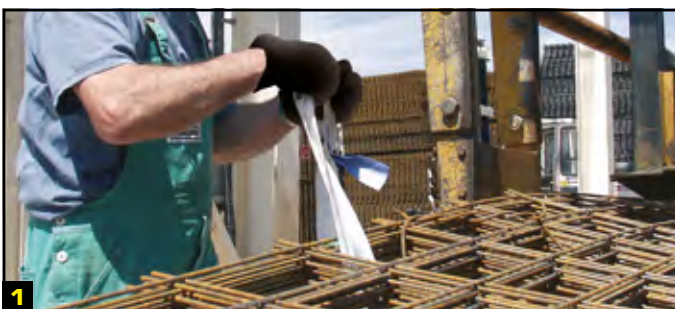
1 Réaliser le passage de l'élingue dans les mailles des treillis soudés. Passer l'extrémité d'accrochage de l'élingue dans la boucle. Enfiler la sangle dans la pièce plastique Li-1, en respectant le sens de la flèche sur le boîtier.
